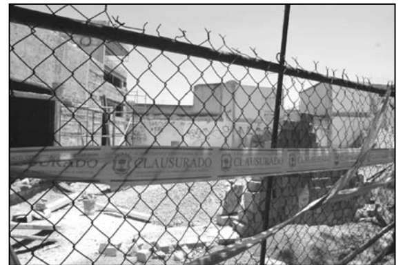
La construcción se encuentra a 20 metros de una escuela
