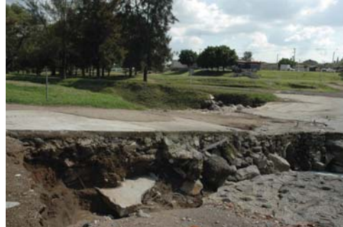
Una mujer se accidentó en un puente sin protecciones
